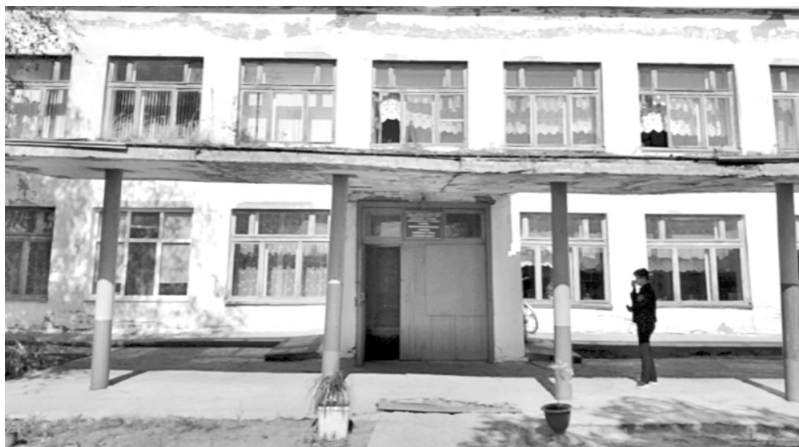
Разрушается фасад школы с. Николевка
